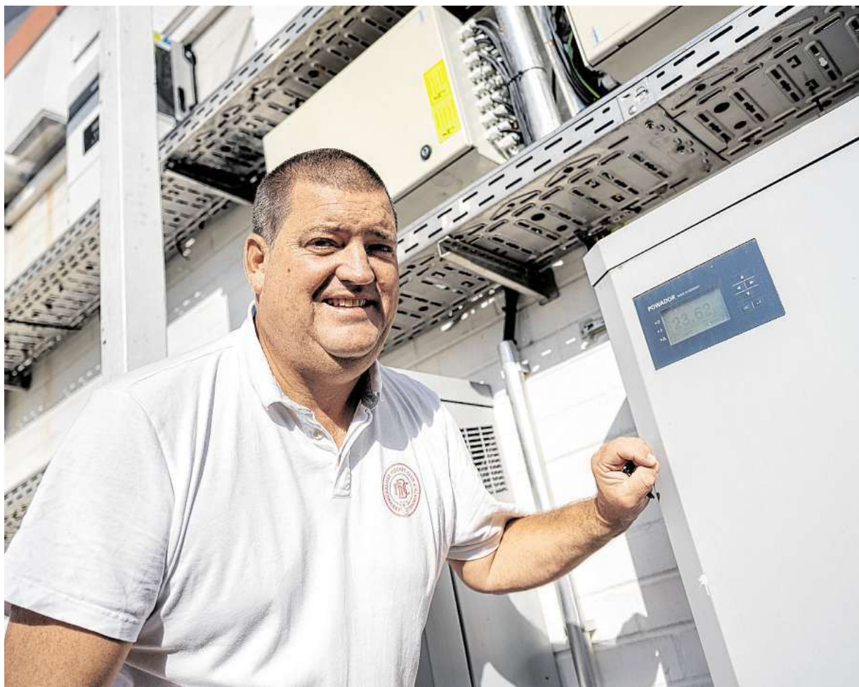
Auf dem Weg zur Klimaneutralität war der Bremer HC gut unterwegs: Hier steht Geschäftsführer Martin Schultze neben dem modernen Wechselrichter der Solaranlage.
